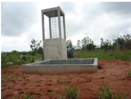
Réserve et poly tank par terre
